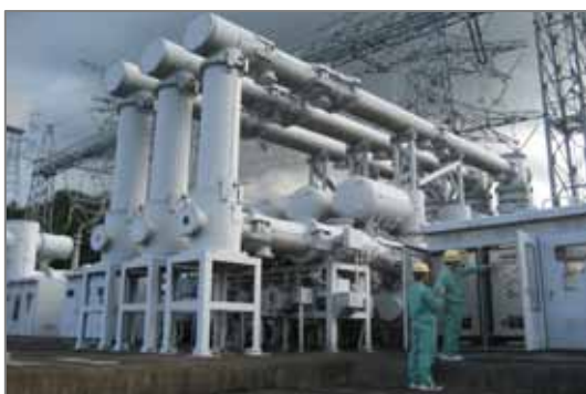
阿波変電所(50万ボルト超高压変電所) 神山町
