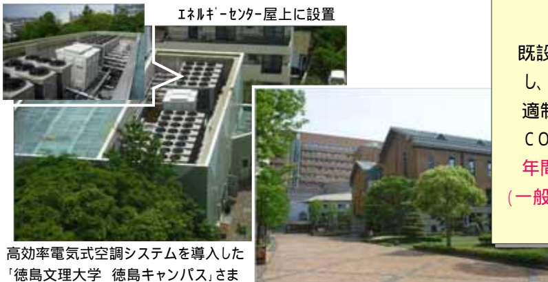
エネルギーセンター屋上に設置
