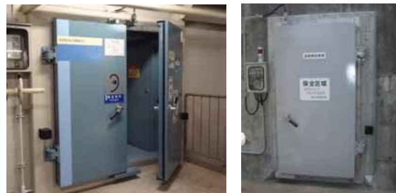
屋外タンクからの溢水による重要施設を配備する部屋の浸水を防ぐため、水密扉にて対応（申請時は自主設置設備）
