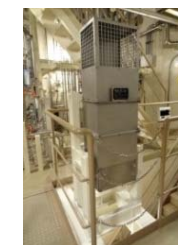
水素処理装置
