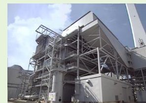
橘湾発電所の排煙脱硫装置
