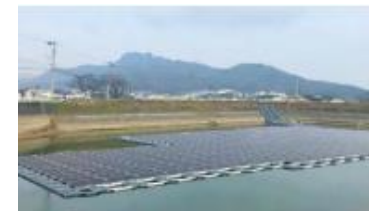
羽間上池・中池水上太陽光発電所 [出力2,190kW]（香川県高松市）
