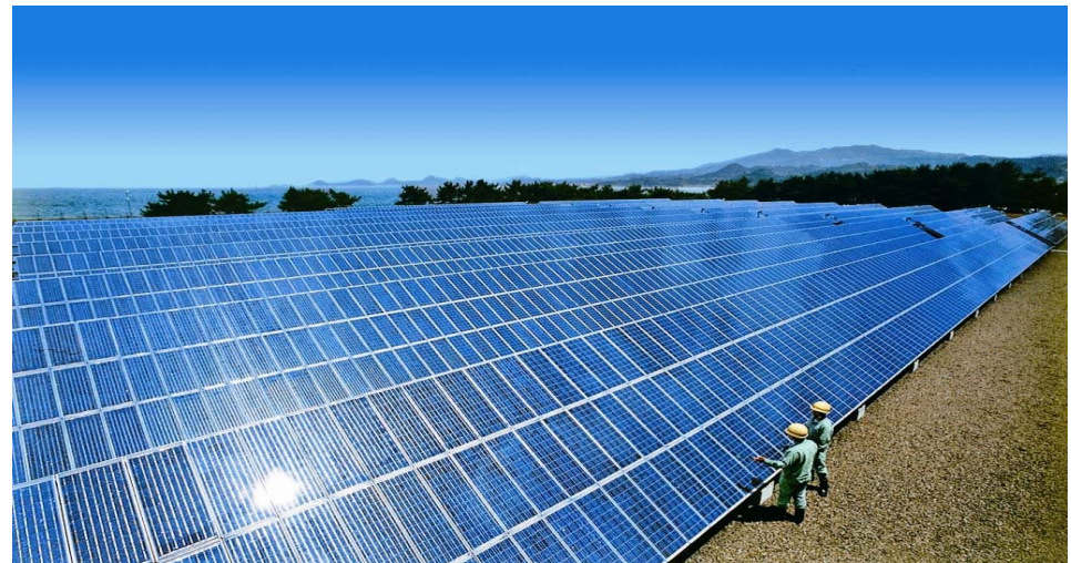
松山太陽光発電所（現状）
