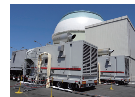
空冷式非常用発電装置
