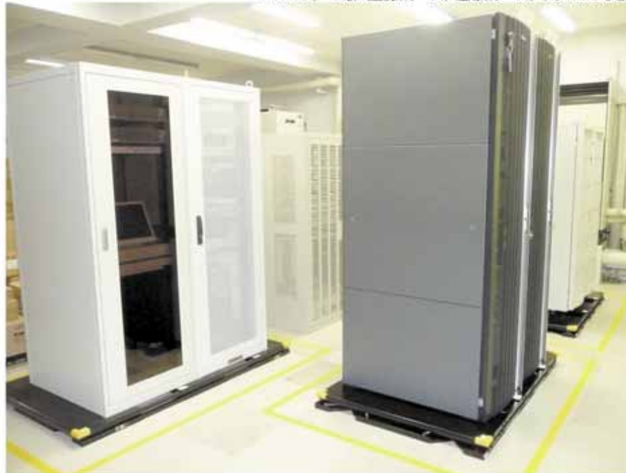
▼ NMSサーバ群 (監視系サーバ、運用系サーバ、サブNMSなど)
