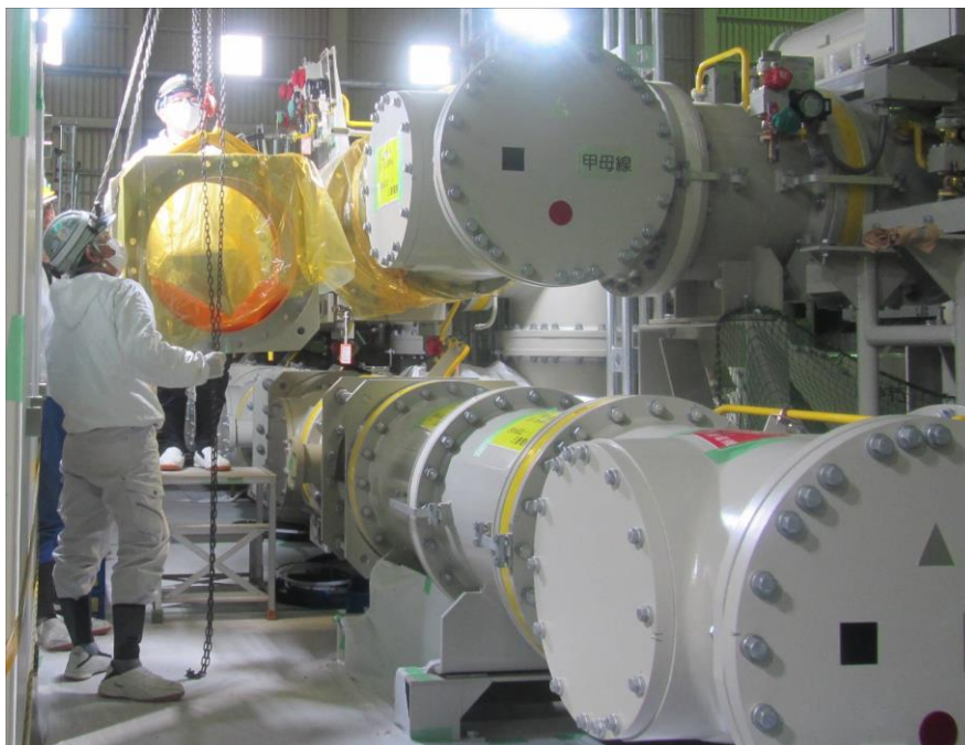
187 kVガス絶縁開閉装置 (GIS) 改造工事状況 (屋内開閉所内 3月15日撮影)
