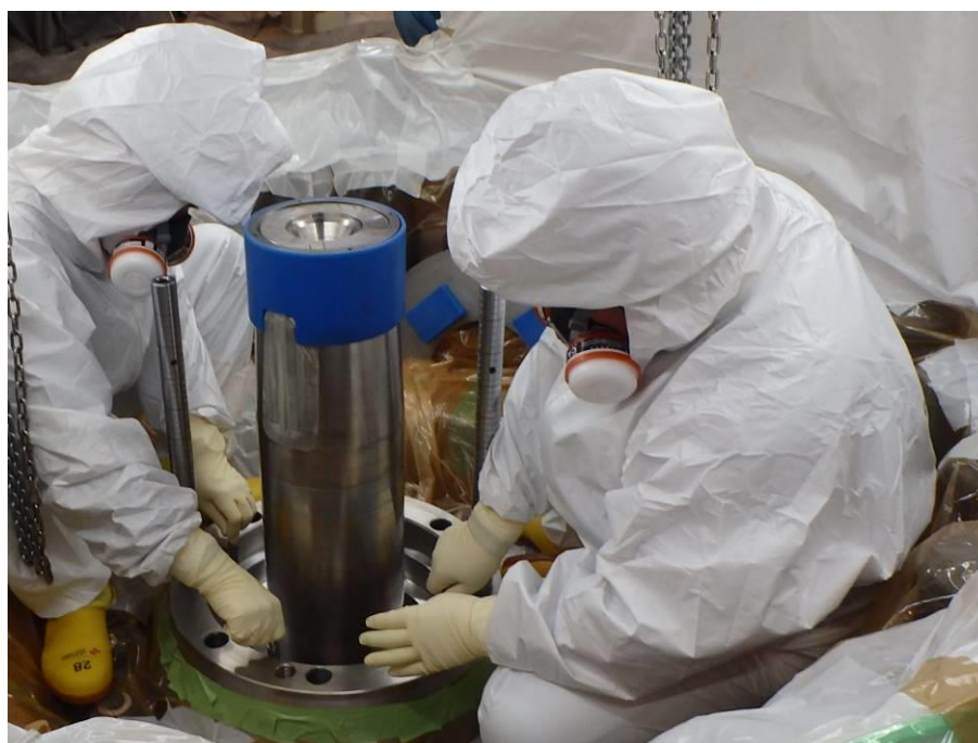
1次冷却材ポンプ点検（軸封部点検※）作業状況（原子炉格納容器内 3月21日撮影）
