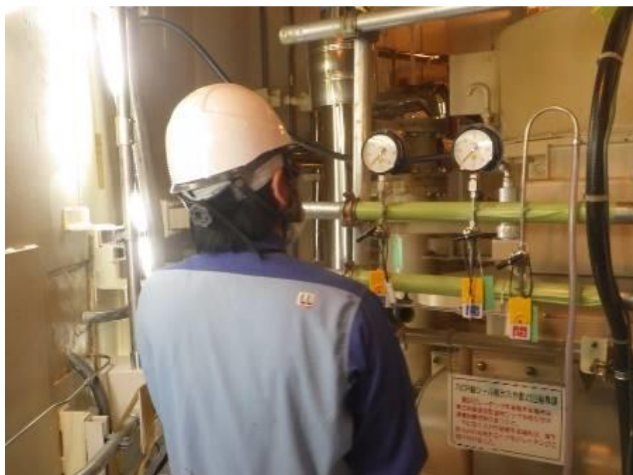
1次系配管取替え工事（耐圧検査※）状況（原子炉格納容器内 3月30日撮影）
