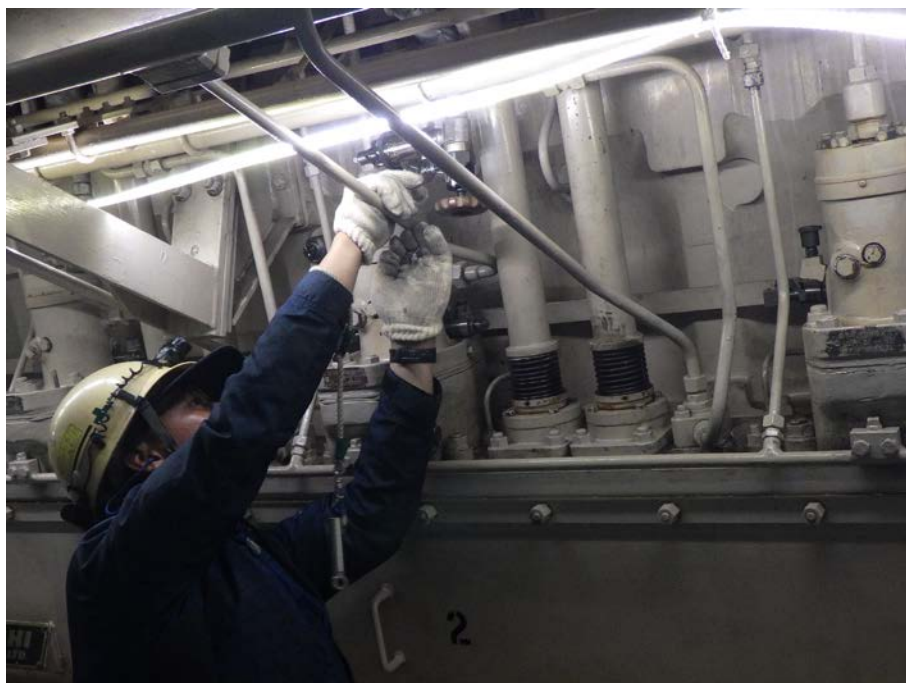
非常用ディーゼル発電機点検（試運転中の圧力測定）作業状況（原子炉補助建屋内 9月3日撮影）
