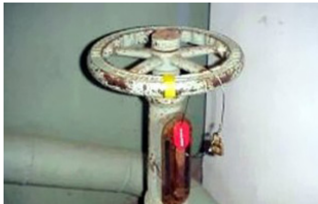
配管の弁閉鎖
