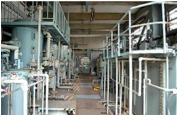
撤去前の水処理装置室内
