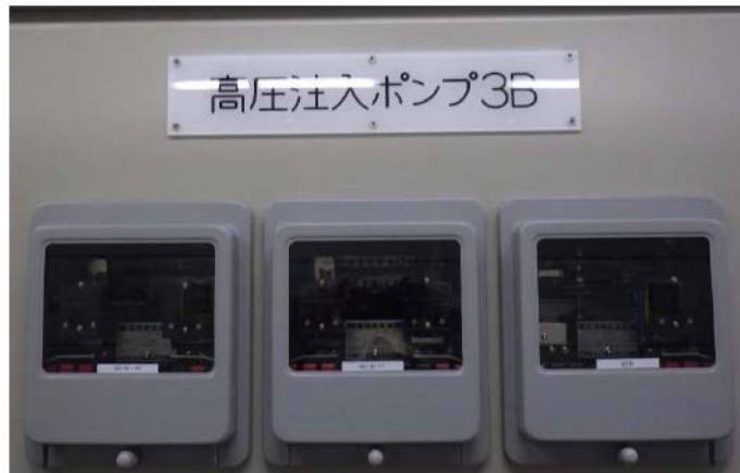
デジタル化前の保護継電器（高圧注入ポンプ 3 B の例）
