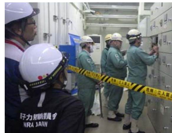
【点検作業 電気回路の健全性試験】
