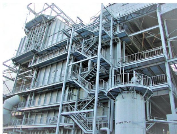
排煙脱硫装置(橘湾発電所)
