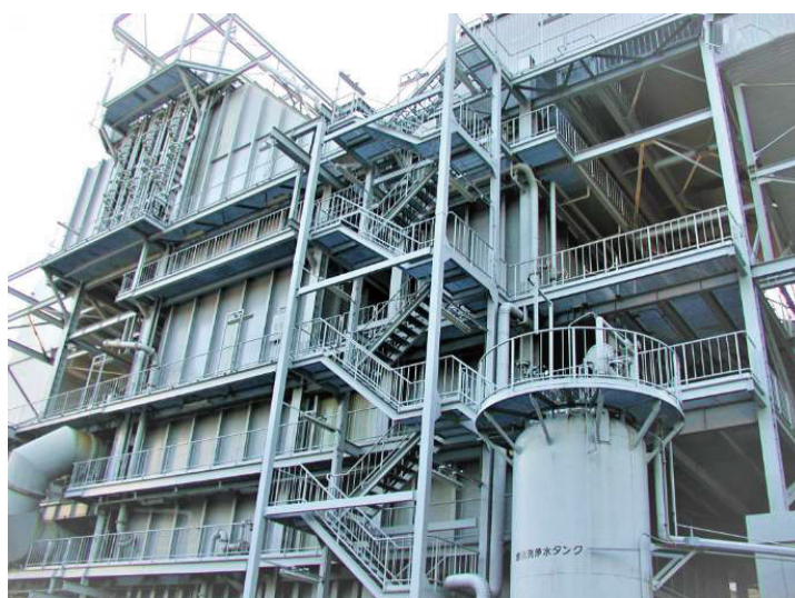
排煙脱硫装置(橘湾発電所)
