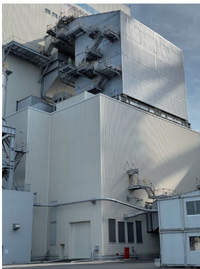
排煙脱硝装置(西条発電所1号機)
