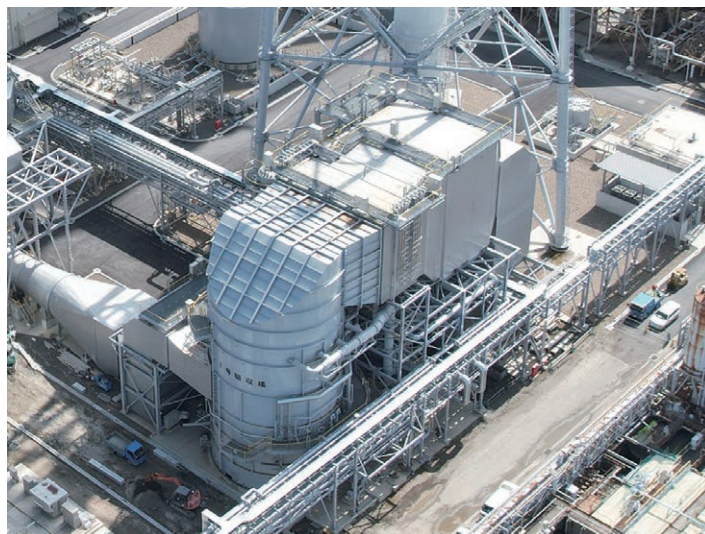
排煙脱硫装置(西条発電所1号機)
