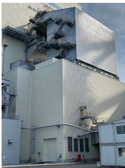
排煙脱硝装置(西条発電所1号機)
