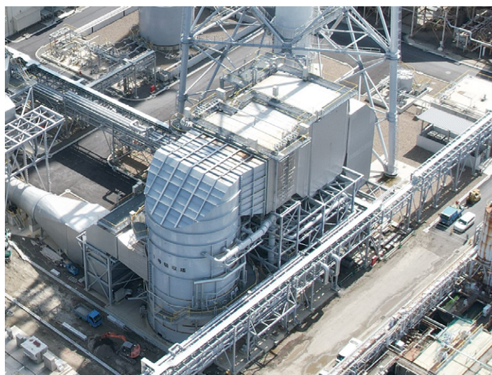
排煙脱硫装置(西条発電所1号機)
