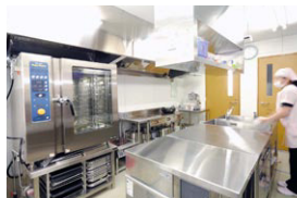
▲クリーンな電化厨房
