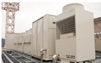
▲屋上にずらりと並んだ電気空調システム
