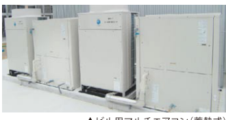
▲ビル用マルチエアコン(蓄熱式)
