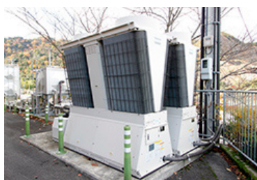
▲ヒートポンプユニット
