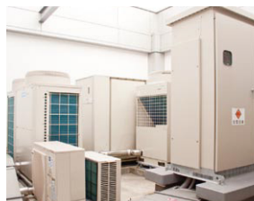
▲屋上に設置された空調システム
