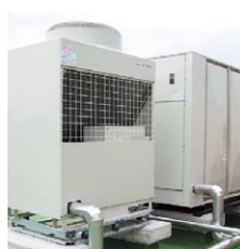
▲ビル用マルチエアコン(蓄熱式)
