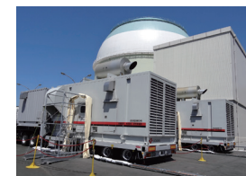
空冷式非常用発電装置
