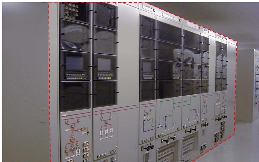
○ 変換所設備の施設状況
