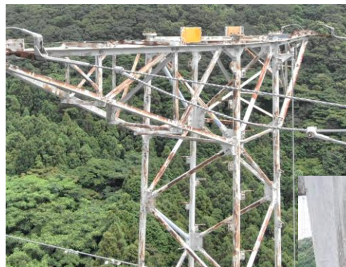
○ 鉄塔部材の劣化状況
