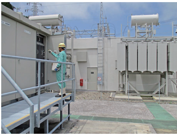
一部かさ上げした変電所設備
