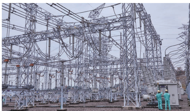
変電設備の巡視風景
