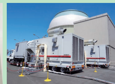
空冷式非常用発電装置
