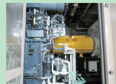
非常用ガスタービン発電機
