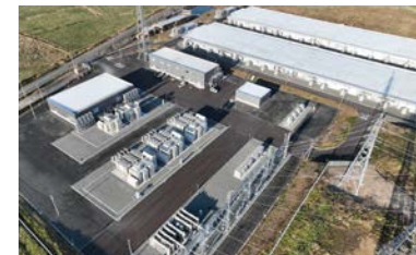
蓄電池を備えた北豊富変電所 (北海道)
