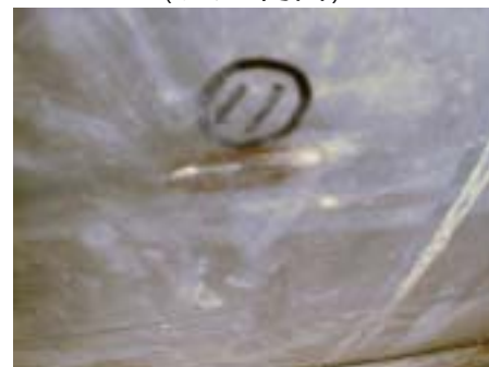
ひび割れ (ダクト内面)
