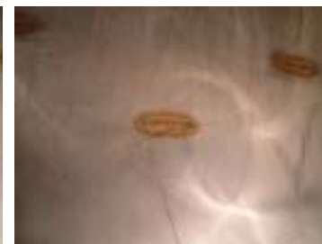
ひび割れ (ダクト内面)
