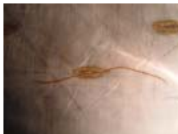
ひび割れ (ダクト内面)
