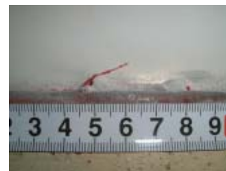
ひび割れ (ダクト外面)
