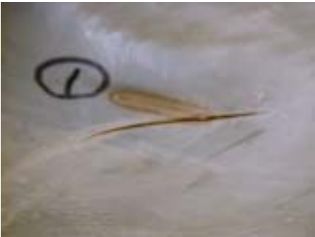
ひび割れ (ダクト内面)
