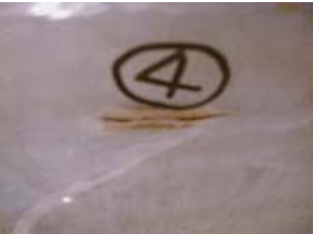
ひび割れ (ダクト内面)
