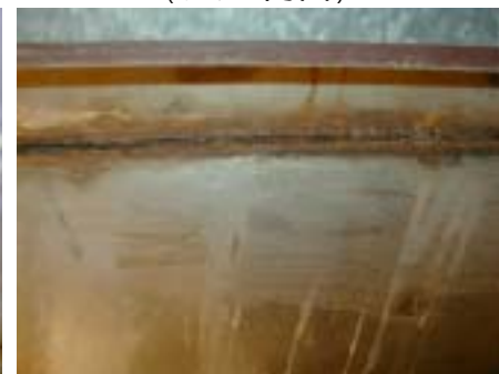
ひび割れ (ダクト内面)
