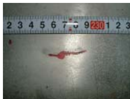
ひび割れ (ダクト内面)
