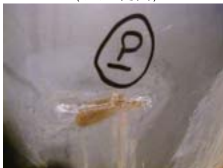
ひび割れ (ダクト内面)
