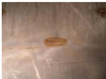
ひび割れ (ダクト内面)
