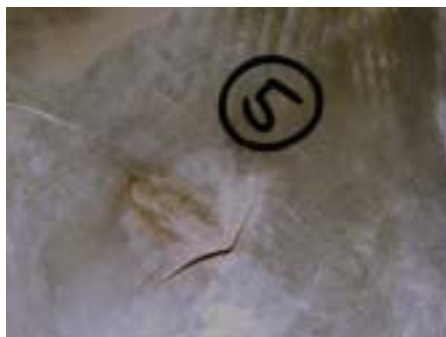
ひび割れ (ダクト内面)
