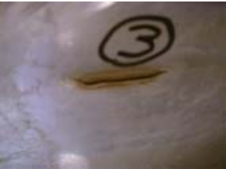
ひび割れ (ダクト内面)
