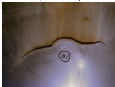
ひび割れ (ダクト内面)
