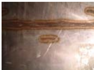
ひび割れ (ダクト内面)
