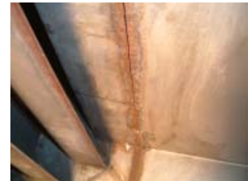
ひび割れ ②① (ダクト内面)
