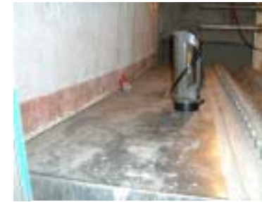
排気筒水平ダクト部 (原子炉補助建家内)
