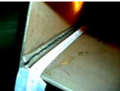
A部割れ状況
